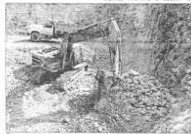
El municipio se encuentra preparado para este temporal de lluvias, ya que en un par de semanas estarán finalizados los trabajos de desazolve en barrancas y en la laguna, afirmó Rober Castrejón Ramírez, asesor de Obras Públicas del ayuntamiento de Tixtla
