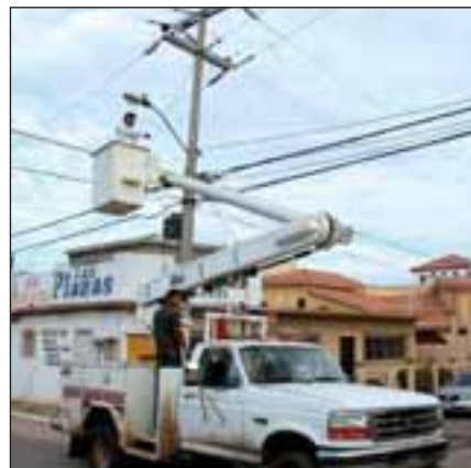
Los cables del alumbrado público serán puestos por aire.
