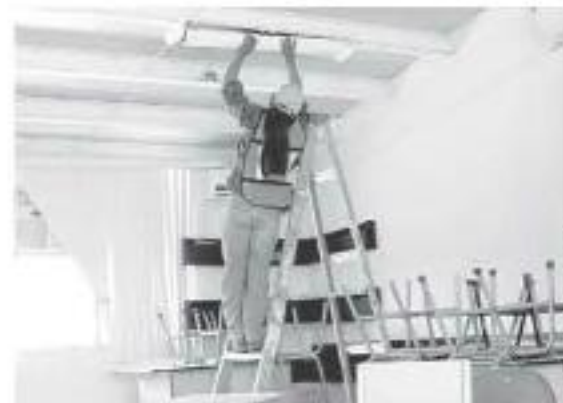
Instalaciones eléctricas son algunas de las obras que se realizan en planteles del Estado.
