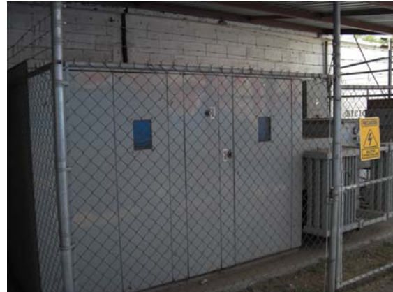
Buenas Condiciones Físicas (Planta de Luz)
